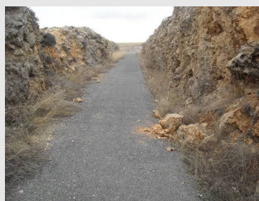
Desprendimientos sobre la vía
